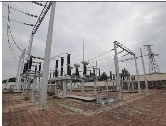
原110kV配电装置（本期需拆除并改造）
