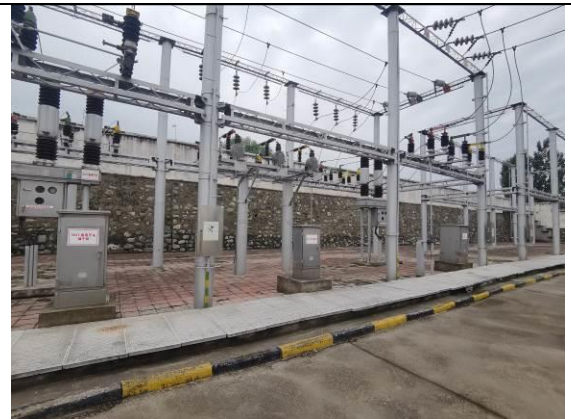
35kV配电装置区
